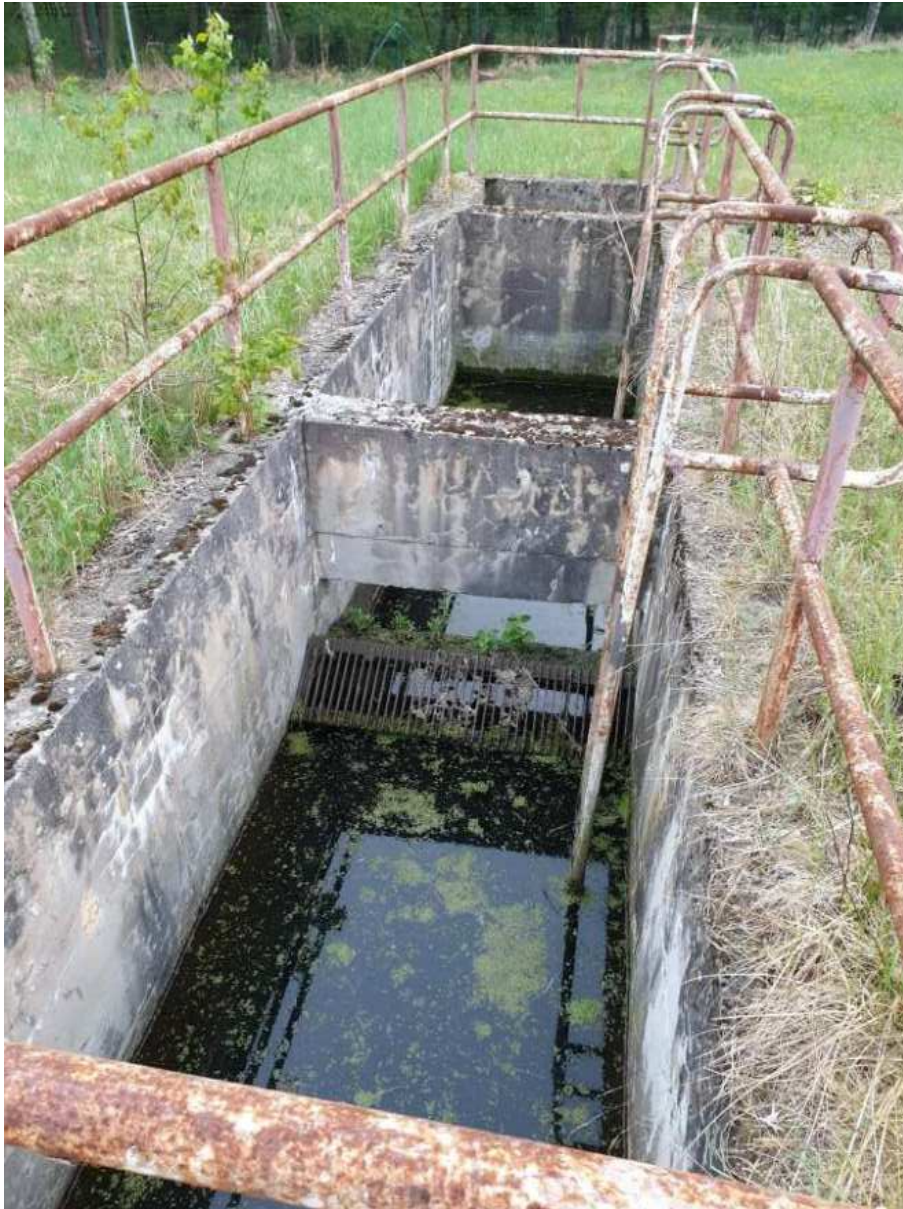
Abbildung 28: Die einzige wasserführende Struktur (Betonbecken) stellt keinen geeigneten aquatischen Lebensraum für Amphibien dar. Ein Entweichen ist unmöglich (Fallenwirkung).
