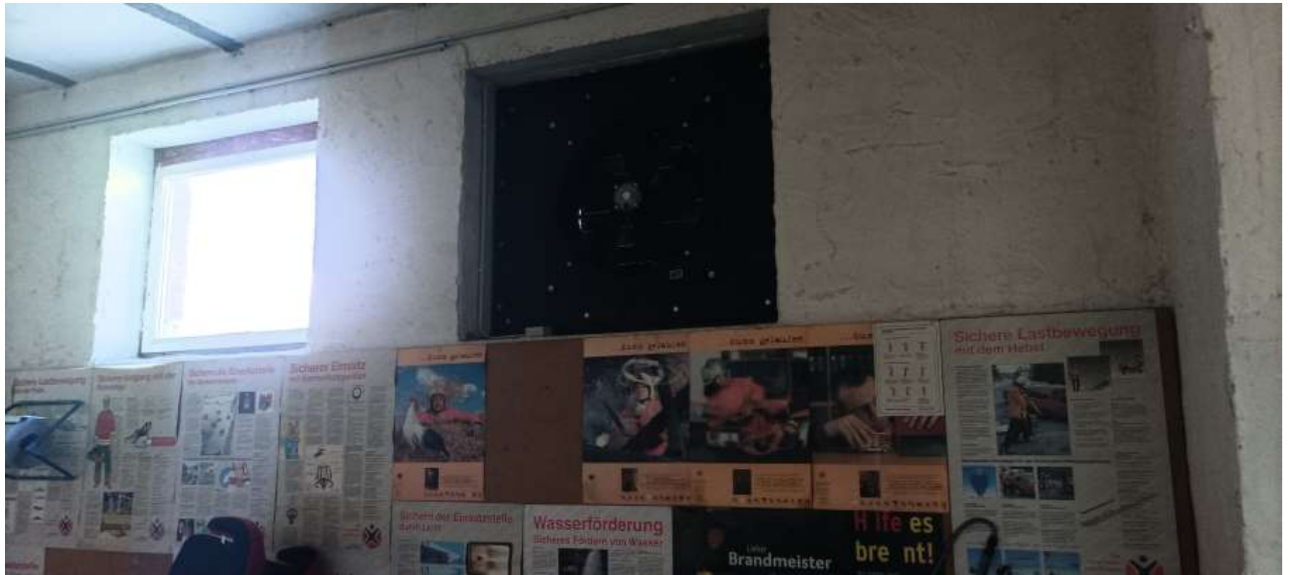
Grafik : Emissionsschutz, Abluftanlage in der Mitte der Gerätehalle
